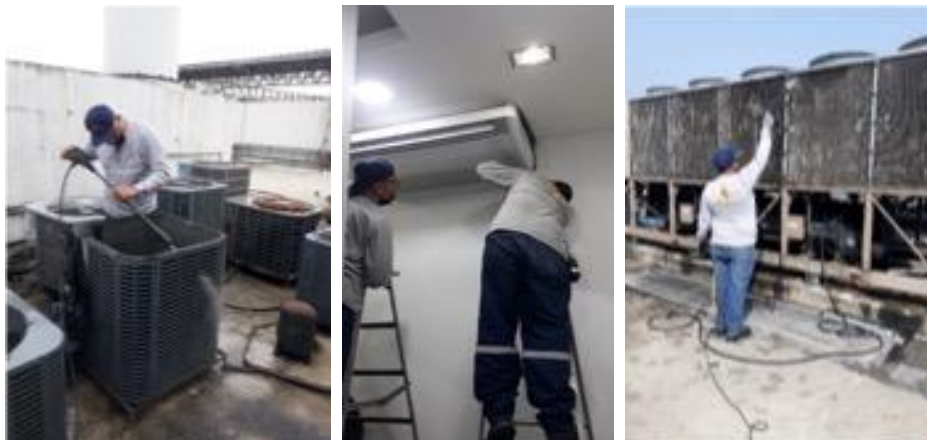
Ilustración Nro. 31 Mantenimiento del sistema de climatización de la TTG y TTMP
